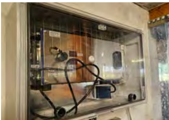
Abbildung 3: Installierter Gaschromatograph (Sniffer) zur Messung der Methanemissionen im Praxisbetrieb (Foto: Schröder, CAU)
